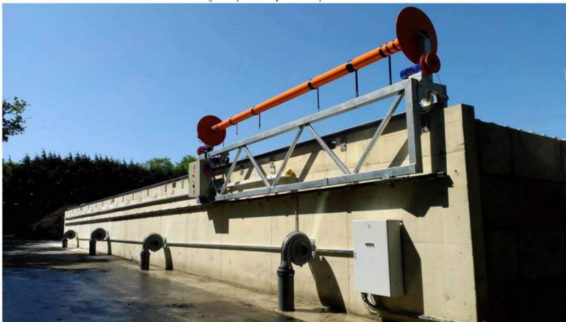
Exemplu stație de compostare din Ungaria.
