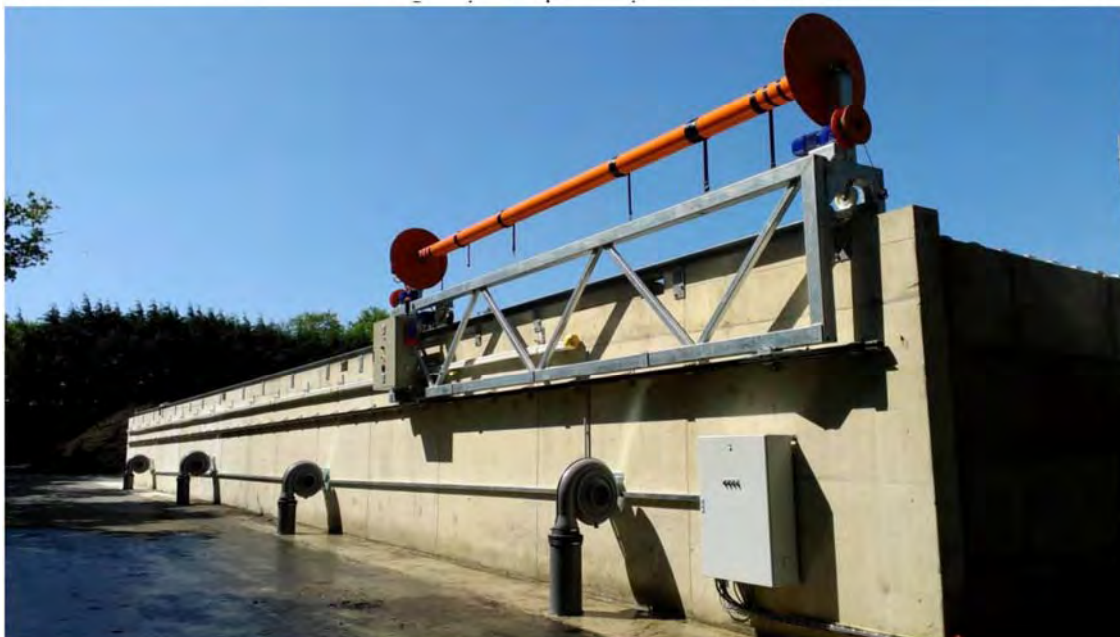
Exemplu stație de compostare din Ungaria.
